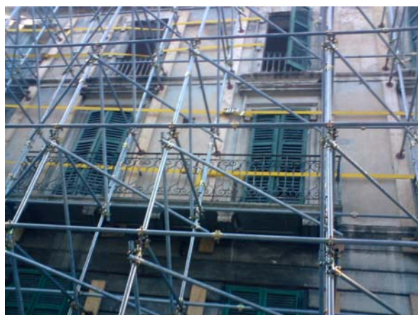
Foto dal sopralluogo a L'Aquila, agosto 2010
