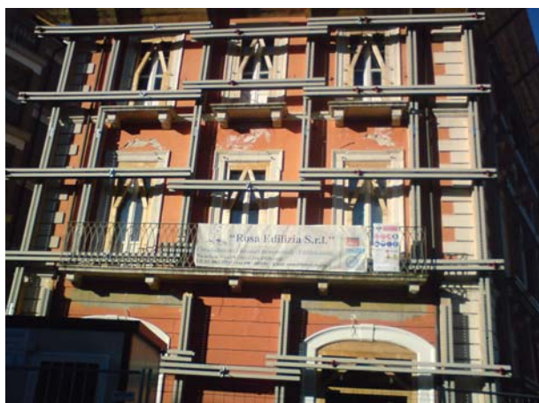
Foto dal sopralluogo a L'Aquila, agosto 2010
